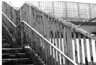
ぼろぼろに錆びた階段が JR東日本のトレードマークか!
